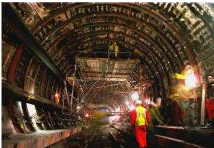
Figura 2.12: Channel Tunnel após incêndio (Fonte: images.theage.com.au/./2008/09/12/tunnel,0.jpg ).
