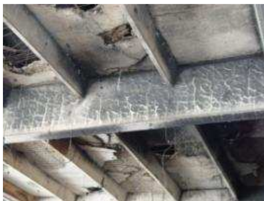
Figura 2.9: Fissuras no cobrimento do concreto de uma viga (LEME/UFRGS, 2007).
