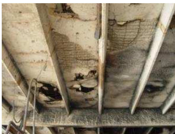
Figura 2.15: Lascamentos explosivos na zona principal do incêndio (LEME/UFRGS, 2007).
