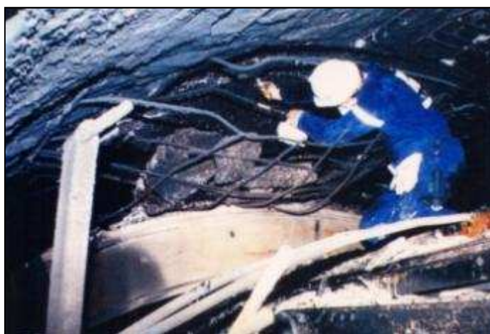
Figura 2.11: Danos no concreto e na armadura após incêndio no Great Belt Link Tunnel (Khoury e Anderberg, 2000).
