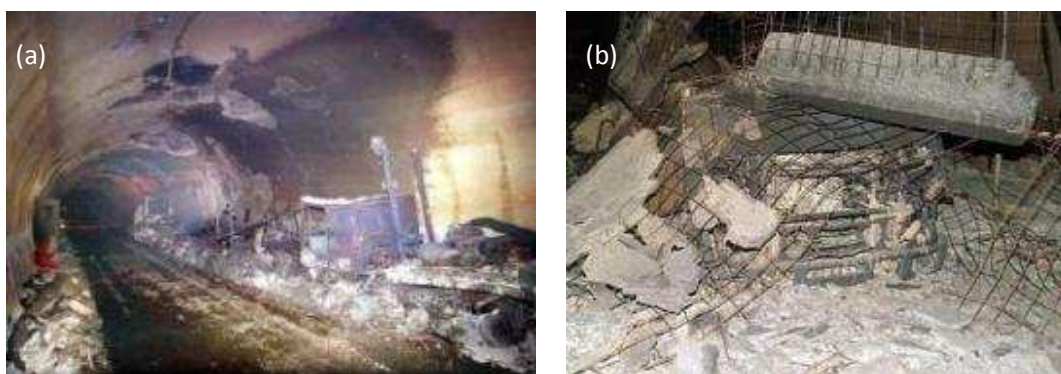
Figura 1.1: (a) Destroços após incêndio no Mont Blanc Tunnel – França-Itália (Brekelmans, 2003) e (b) Colapso estrutural de partes dos anéis do Gotthard Tunnel - Suíça (Costa et al., 2002).
