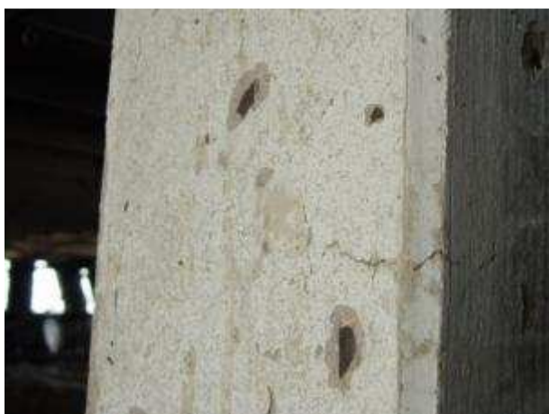
Figura 2.8: Formação de sulcos na superfície do elemento de concreto (LEME/UFRGS, 2007).
