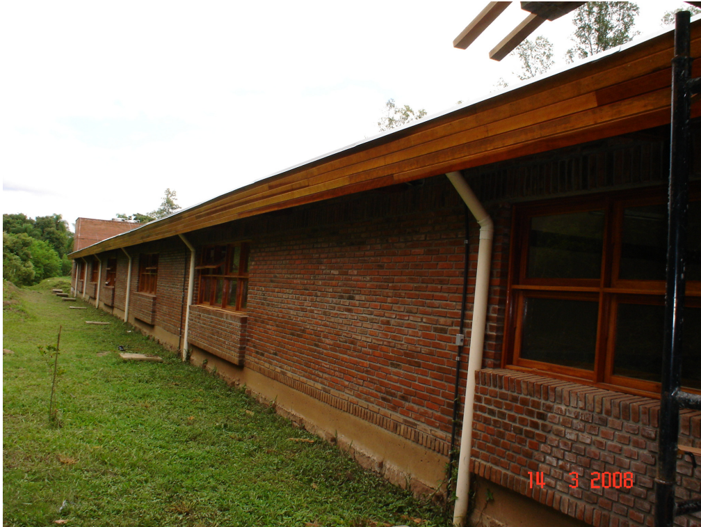
Figura 8: Pormenor do processo de captação de águas pluviais.
