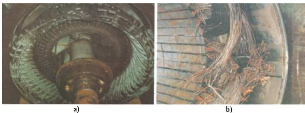
Figura 3: Dois exemplos de falhas: a) queima e b) curto no estator (WEG, 2002).
