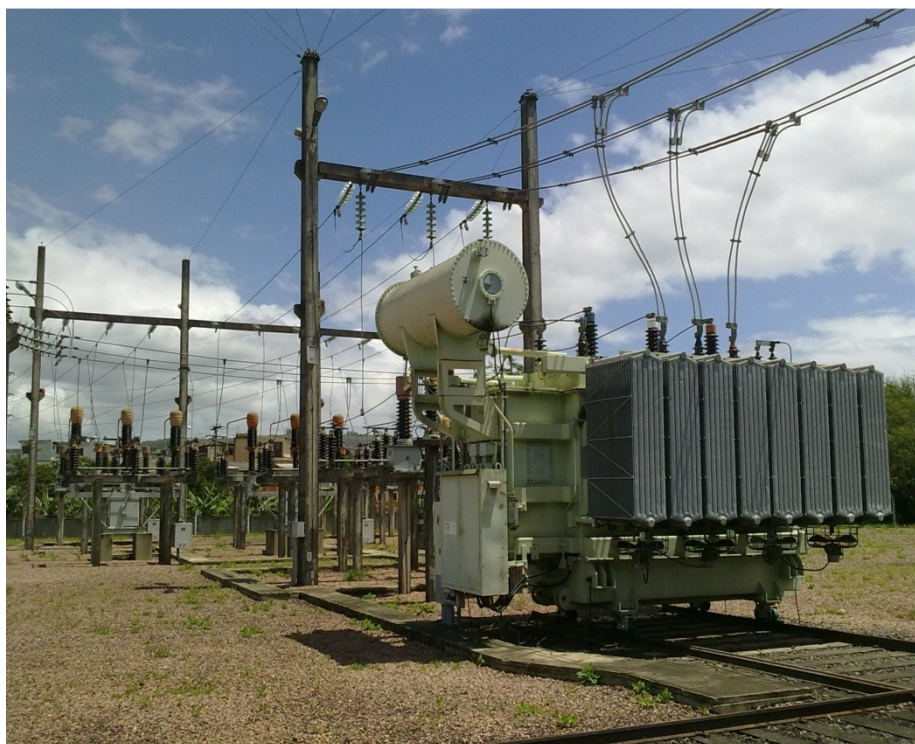
Figura 9: Subestação Porto Alegre 16.
