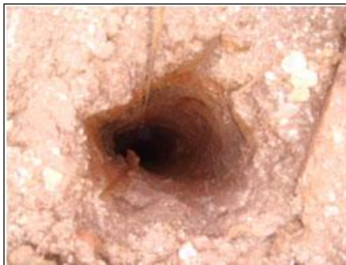
Figura 4.4 – Aspecto da boca de furo de sondagem com aproximadamente um mês de conclusão, onde ocorrem irregularidades externas que podem se agravar em profundidade.
