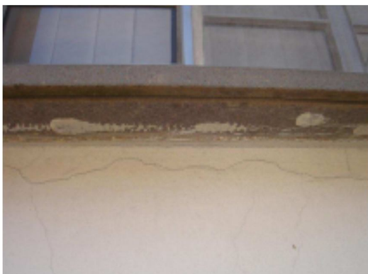
Figura 1: Fissura horizontal sob a pingadeira
