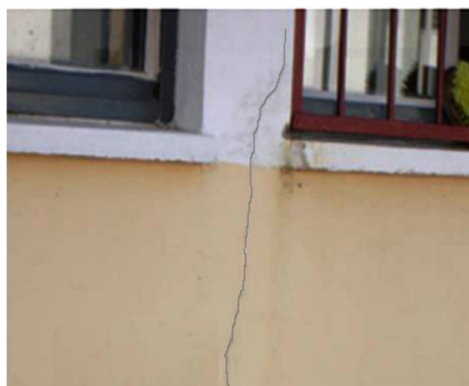
Figura 2: Fissura originada próximo à esquadria.
