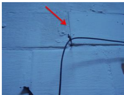
Figura 76: Fissura na interface alvenaria/ esquadria
