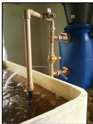
Figura 1 - Tanque com filtro biológico
