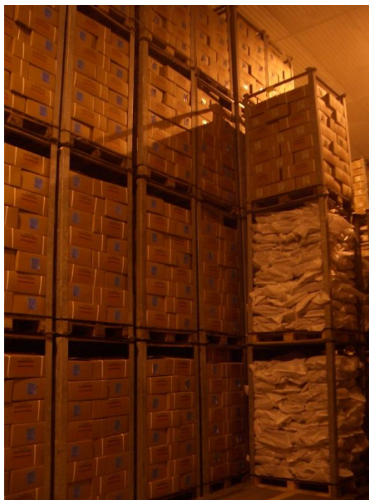
Figura 13 - Câmara frigorífica de estocagem com produtos armazenados em lotes identificados. Direitos autorais: Greice Franzon.
