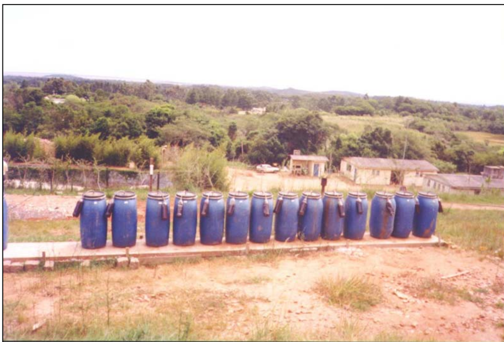
Figura F.20 – Vista posterior dos reatores do sistema anaeróbio de tratamento
