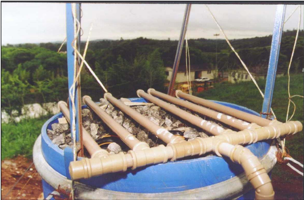
Figura F.31 – Sistema de gotejamento de lixiviado no filtro aeróbio, composto por 6 canos de PVC perfurados
