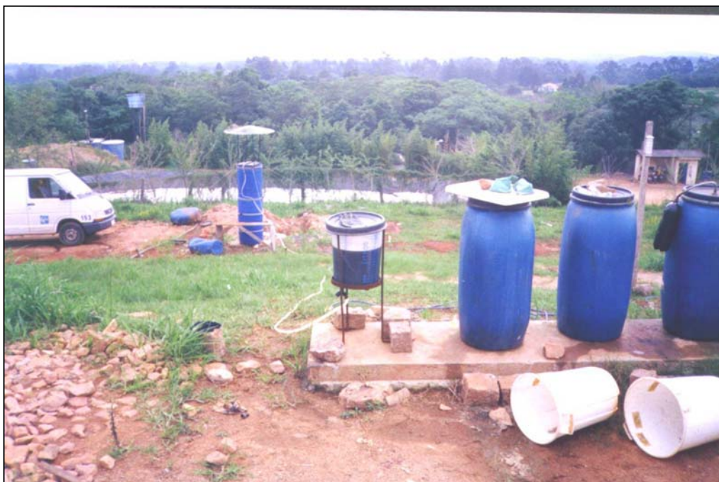
Figura F.30 – Vista geral do sistema de aplicação de lixiviado ao filtro aeróbio por gravidade
