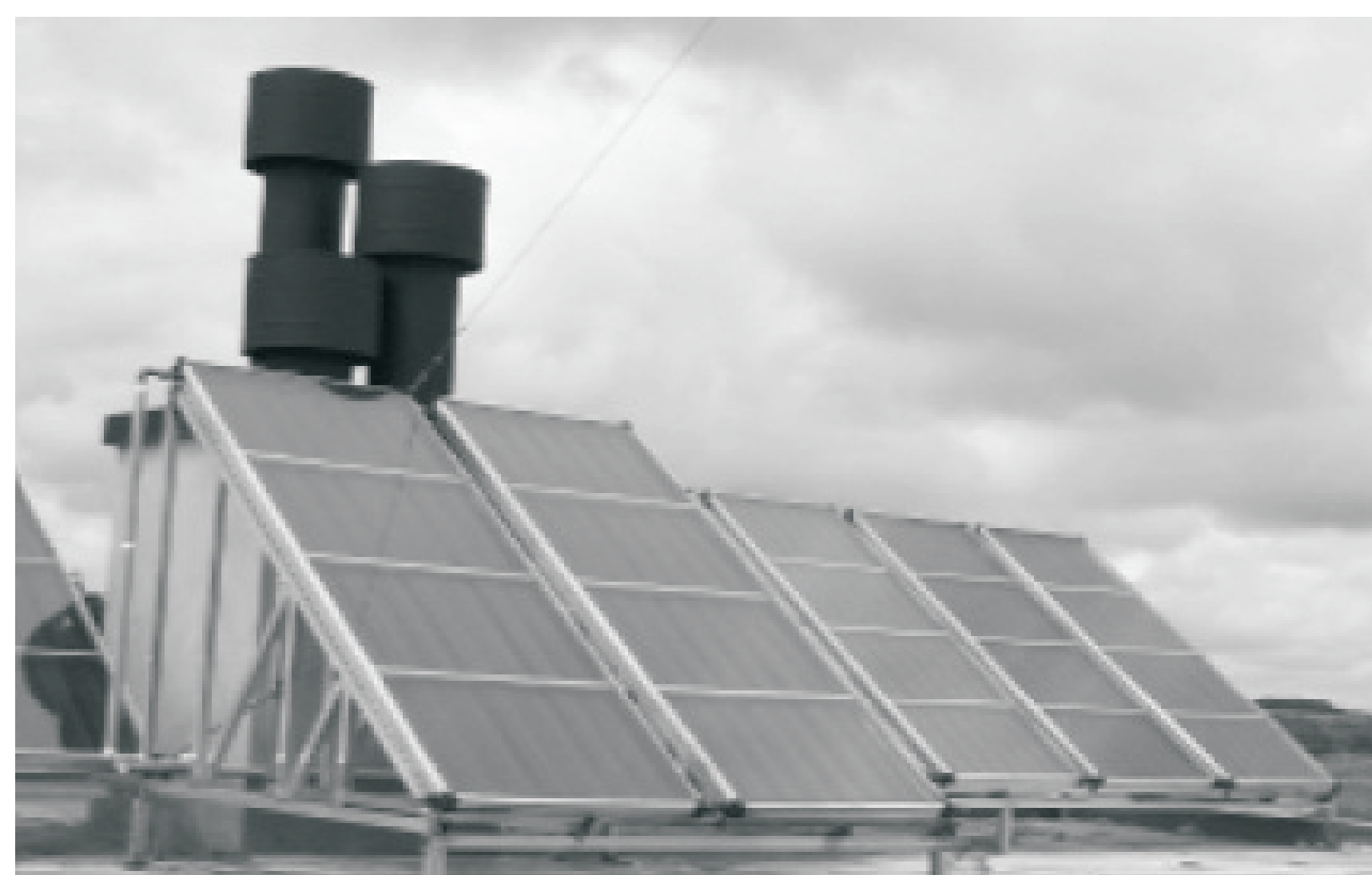
Figura 2 - Placas Fotovoltaicas para aquecimento solar na edificação avaliada situada na Rua do Comércio, esquina com a Rua Aimorés, Bairro Pindorama, Ijuí/RS.
