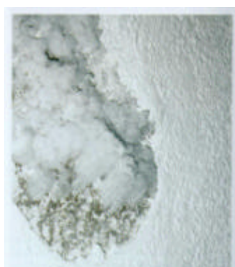
Figura 5: eflorescência em alvenaria (FRÖSSEL, 2001, p. 292)
