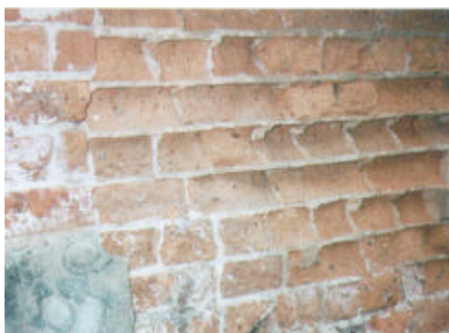
Figura 6: crisptoefflorescência em alvenaria (FRÖSSEL, 2001, p. 292)
