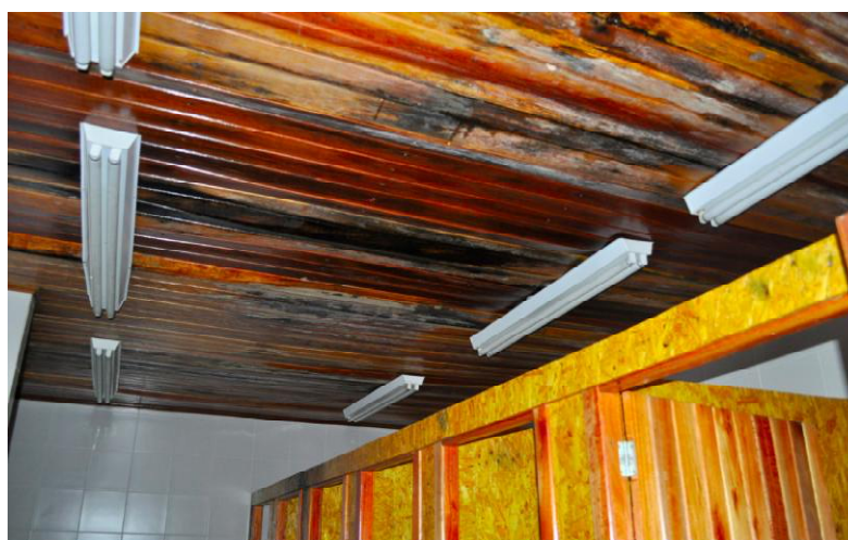
Figura 48. Infiltração no telhado do banheiro masculino
