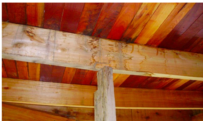
Figura 37. Infiltração na cobertura verde, área externa, em frente ao bloco 4
