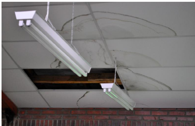
Figura 47. Infiltração no telhado das salas
