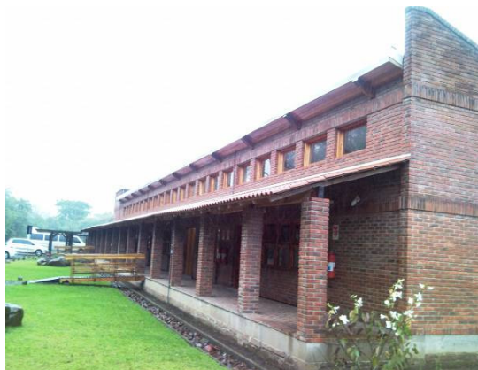
Figura 17: Telhado de águas desencontradas.
