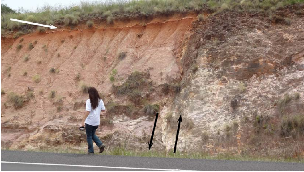
Figura 24. Setas pretas indicam a movimentação dos pacotes causada por falhas. Seta branca mostra nível que contém seixos silicosos e fragmentos de lenhos sobrepostos por solo.
