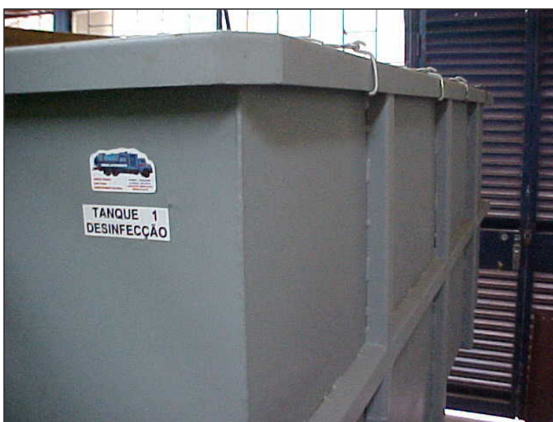
Fig.4.12: Detalhe do tanque de desinfeção.
