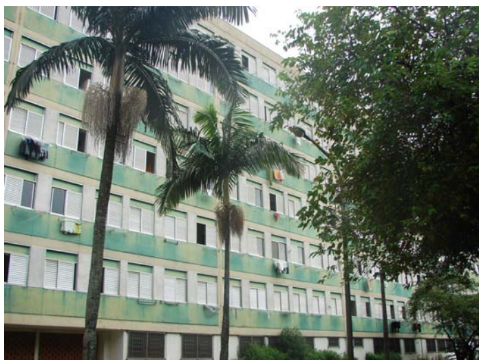
Fig. 95: Fachada dos dormitórios descaracterizada.
