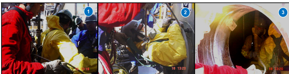
Figura 9 – Trabalho em Espaço Confinado.
