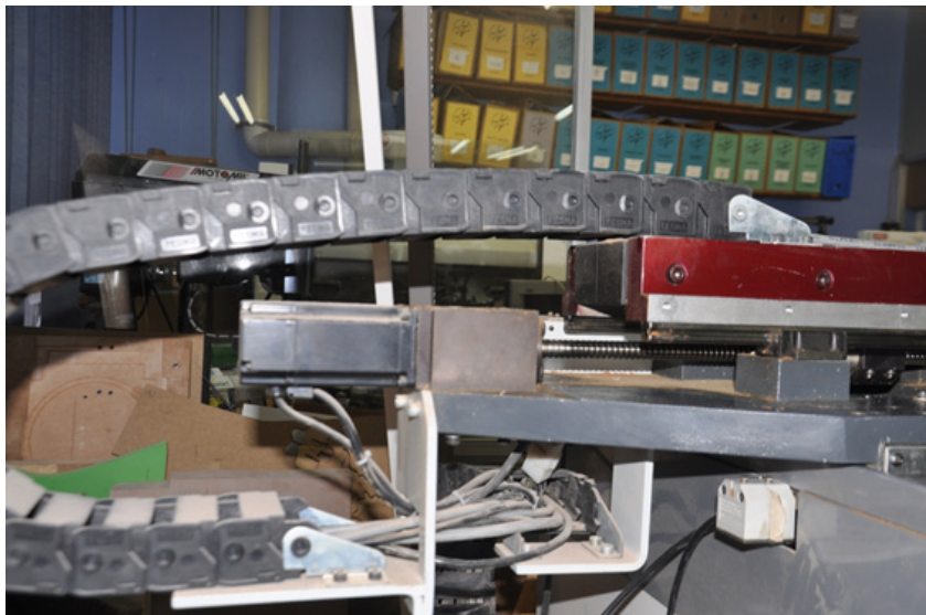
Figura 55 - Sistema de esteira porta cabos para organização dos fios.
