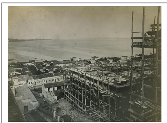
“ CONSTRUÇÃO DO PALÁCIO PIRATINI – FOTO 1912 ” (SOP, 1962), ao fundo na ilustração se vê a parte sul da península, que configura a área central de Porto Alegre, antes de ser aterrada, quando então, as margens do Lago Gauíba chegavam até a atual Rua Wahington Luís.
