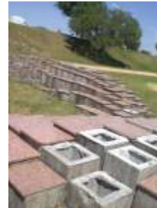
Foto 106: Péssimo estado da obra
