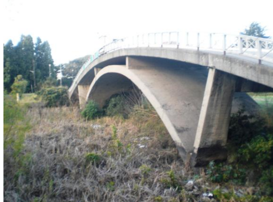
Foto 45: Antiga ponte abandonada Fonte: Otávio Vieira – 31 de julho de 2010
