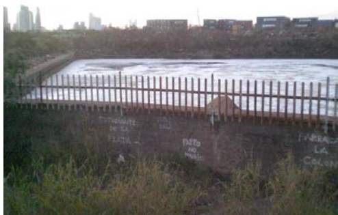
Foto 40 : Local de despejo de material poluente Fonte: Otávio Vieira – 5 de setembro de 2010
