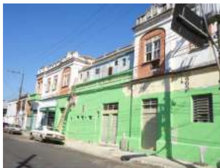
Foto 119: Casa sendo reformada na Rua Comendador Fonte: Otávio Vieira – 8 de abril de 2011
