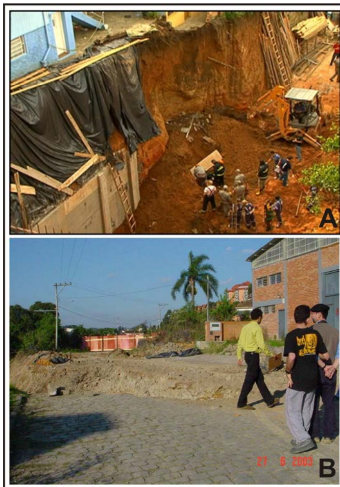
Figura 1. A - deslizamento de terra no centro de Caxias do Sul (Fonte: RBS TV 10/2009); B - Ruptura em escavação junto à Avenida Perimetral (Fonte: BRESSANI; FLORES; NUNES, 2005).
