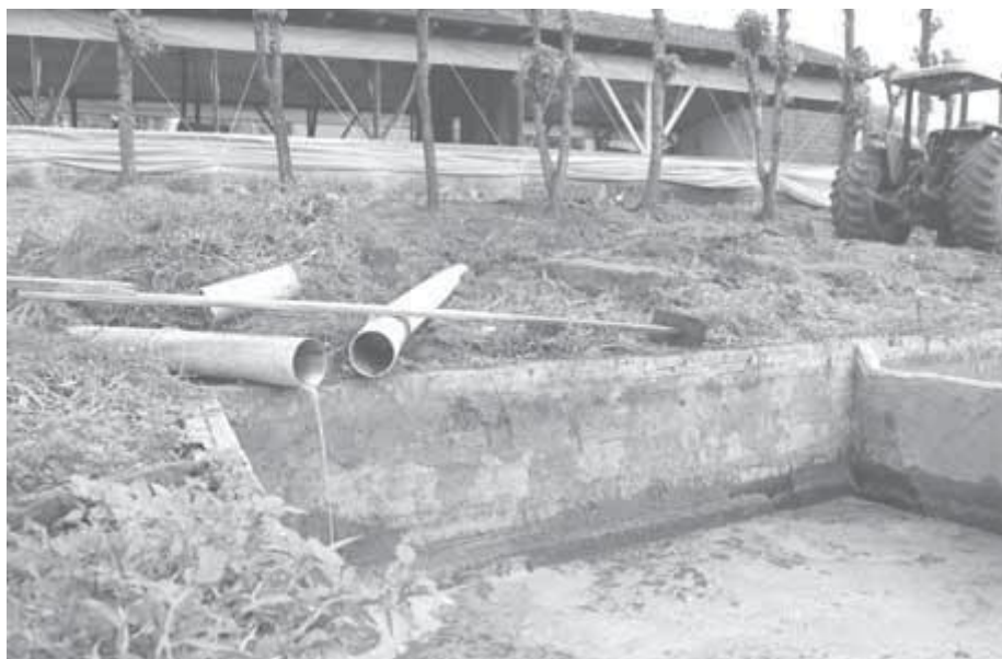
Foto 36 - Caixa de captação dos dejetos da unidade mecanizada e automatizada (UMAC) da propriedade dos irmãos Kummer – Itapiranga/SC
