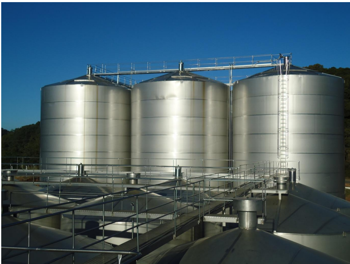
Figura 1.2 Tanque de armazenamento com teto cônico
