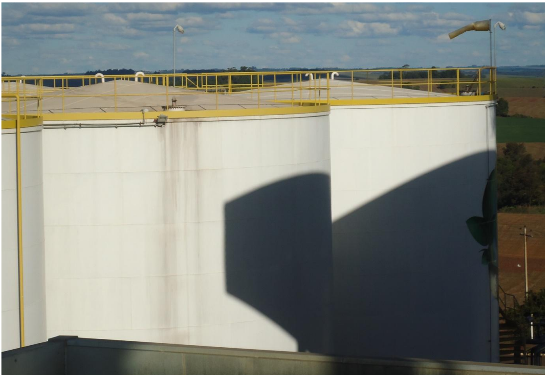
Figura 1.1 Tanque de armazenamento com teto cônico
