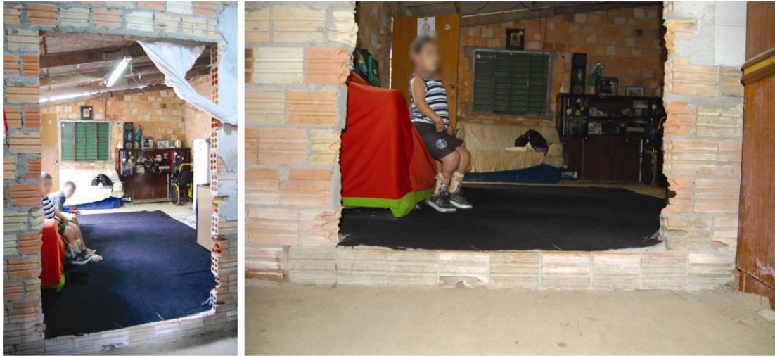
Figura 74 - Degrau que divide a sala do quarto Fonte: Fotos da autora
