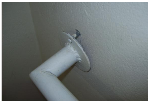
Figura 36 – Barra de apoio caindo da parede
