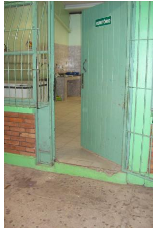
Figura 51 – Degrau na entrada do refeitório
