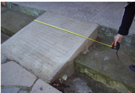
Figura 54 – Rampa com largura menor que 1,20 m
