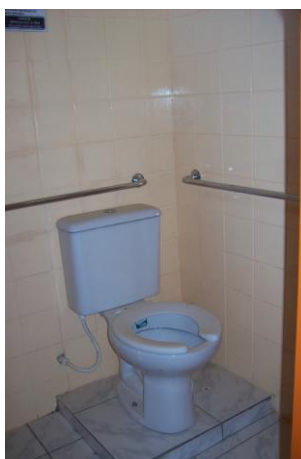
Figura 55 – Sanitário com piso irregular
