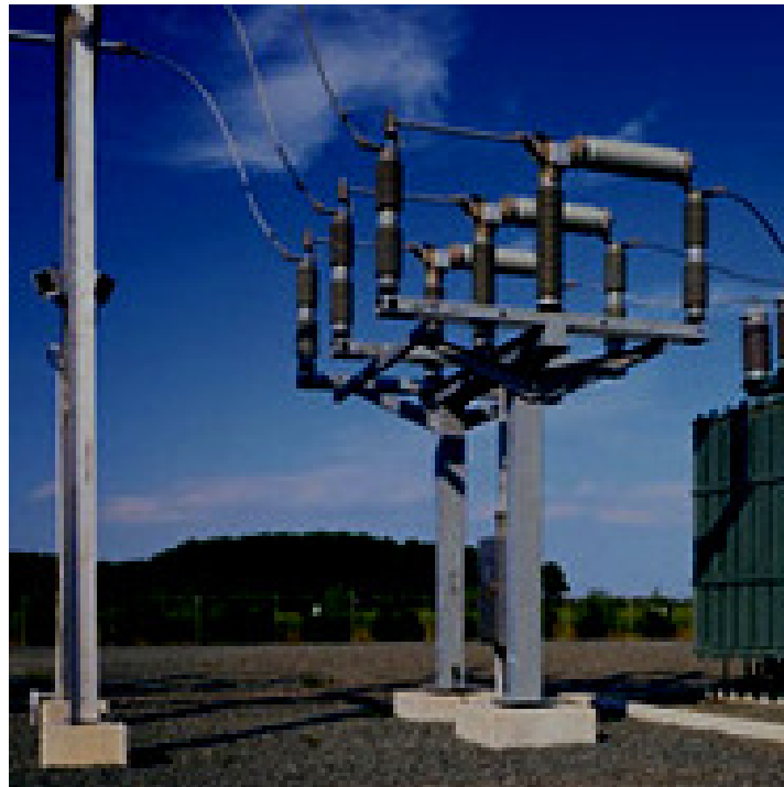
Figura 13: Chave Seccionadora 69kV - S&C.
