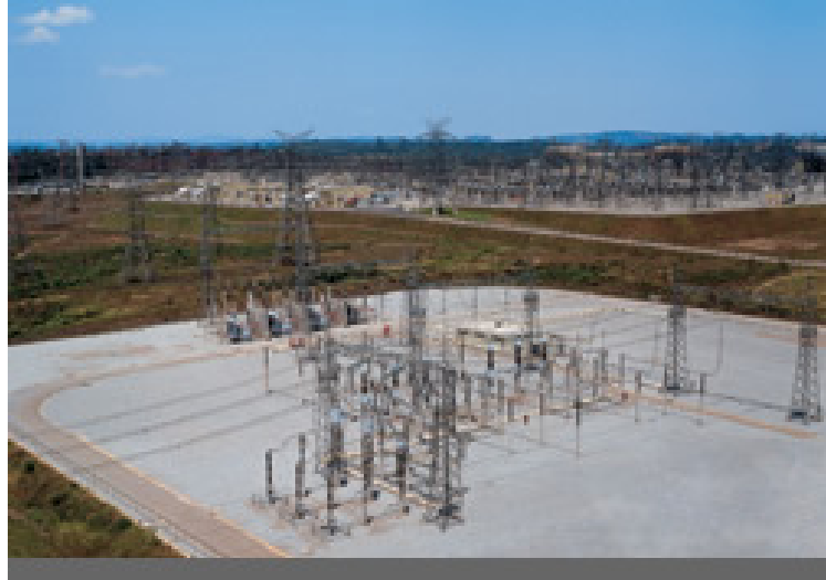
Figura 1: Subestação 500kV – Furnas – Ibiúna, SP.
