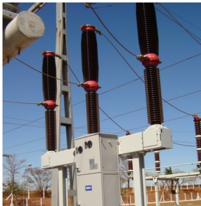
Figura 12: Disjuntor 69kV - AREVA.
