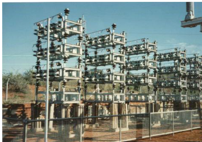
Figura 16: Banco de Capacitores.
