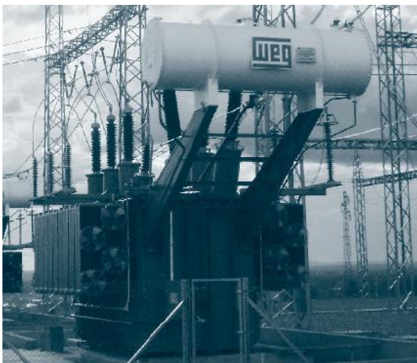
Figura 4. Transformador de Força WEG 500kV.
