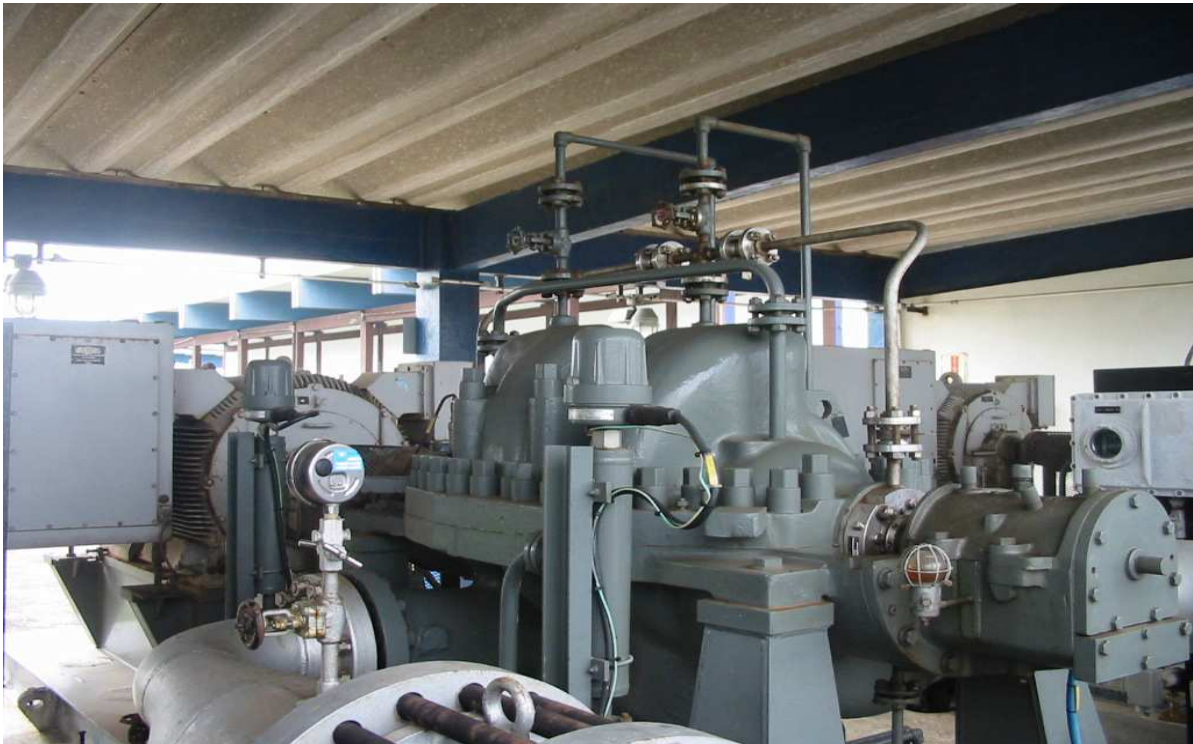
Figura 22 – Bombas de petróleo
