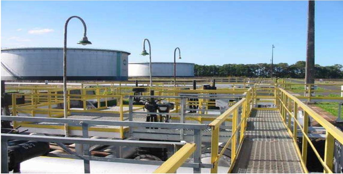
Figura 21 – Tancagem de nafta e nódulo de válvulas
