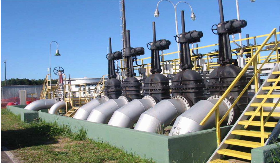
Figura 23 - Nódulo de válvulas
