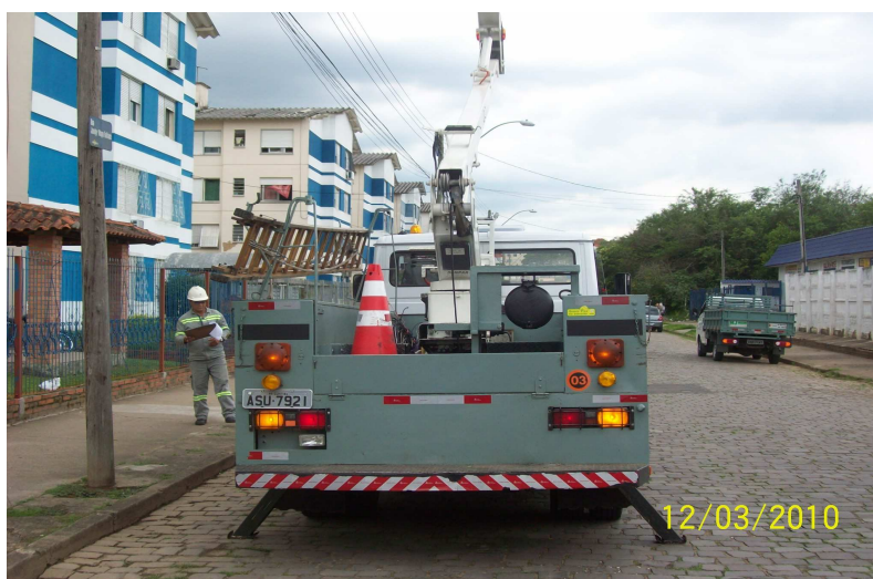
Figura 5.5 – Risco de queda de cima caçamba do veículo
