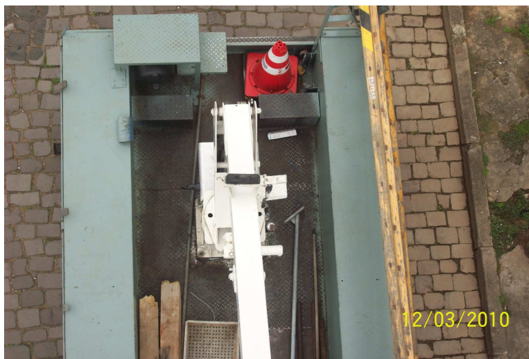
Figura 5.4 – Risco de queda do cesto elevatório
