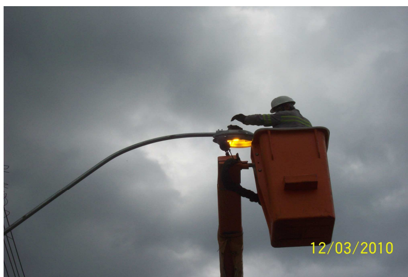
Figura 5.6 – Risco de choque elétrico e queimadura
