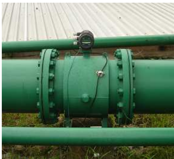
Figura 3.8: Medidor de vazão usado neste estudo.
