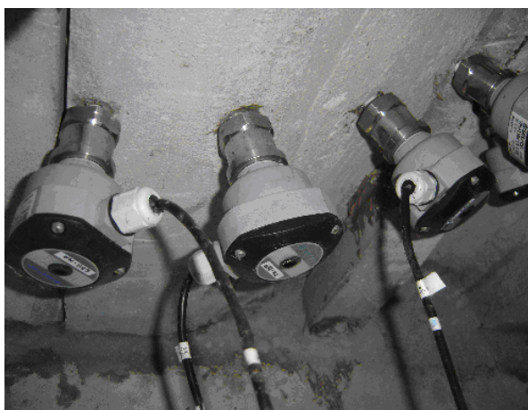
Figura 3.11: Transdutores de pressão instalados no fundo da bacia de dissipação.
