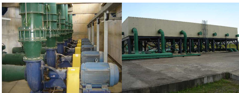
Figura 3.7: Casa de bombas do reservatório de nível constante e tubulação.
