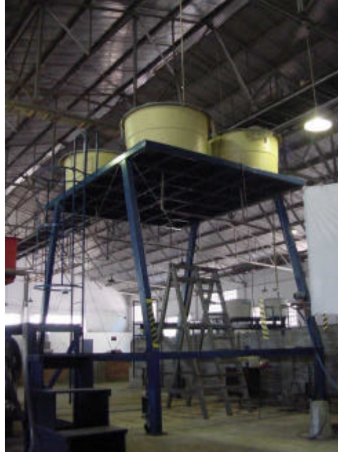
Figura 5.4: Reservatórios de alimentação e estrutura de suporte.
