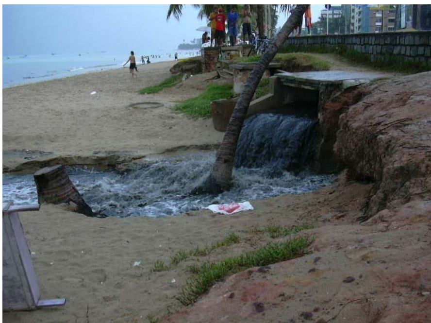
Figura 3: Despejo de águas pluviais em praias (Maceió).
