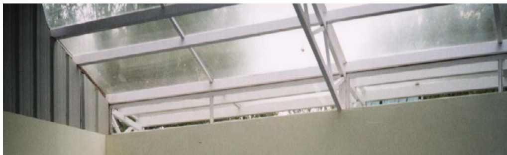
Figura 76 - close da cobertura de fibra de vidro, mostrando sua inclinação para o escoamento da chuva
