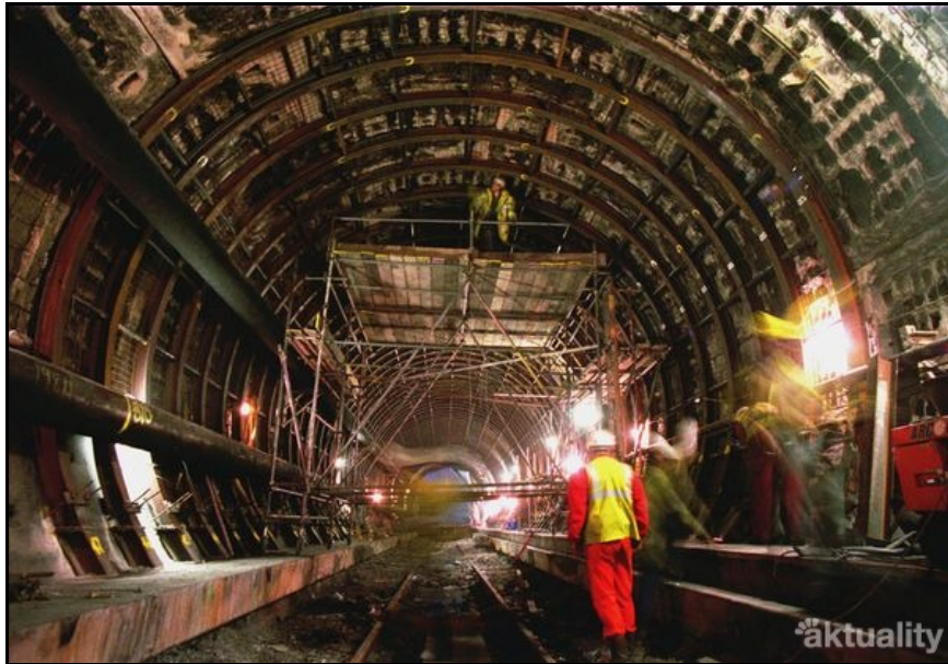
Figura 1: seção do Eurotúnel após o incêndio de 2008 (G1, 2008).
