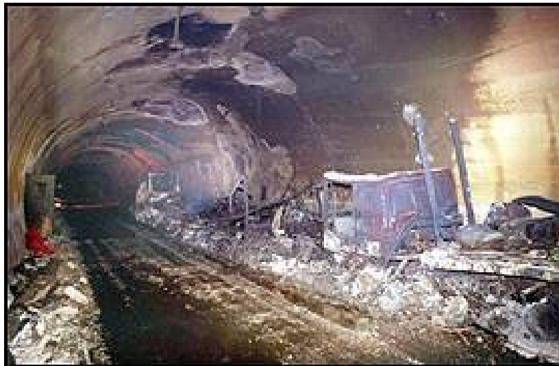
Figura 2: seção do túnel Mont Blanc após o incêndio de 1999 (BBCBrasil, 2002).
