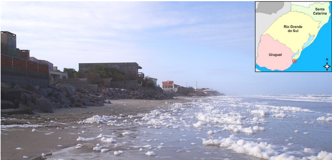
Figura 1 – Proteção de edificações com rochas e sacos de areia em sua base para evitar os efeitos da erosão costeira no Balneário do Hermenegildo (↑ NE) 1 .
