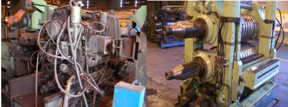
Figura 17 - Gaiola D6 com muitas mangueiras para lubrificação e refrigeração e após a instalação de distribuidores
