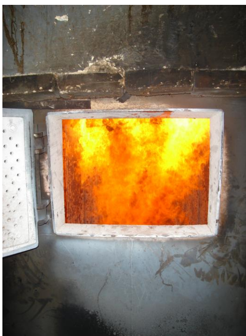
Figura 4 – Detalhe da caldeira em operação.
