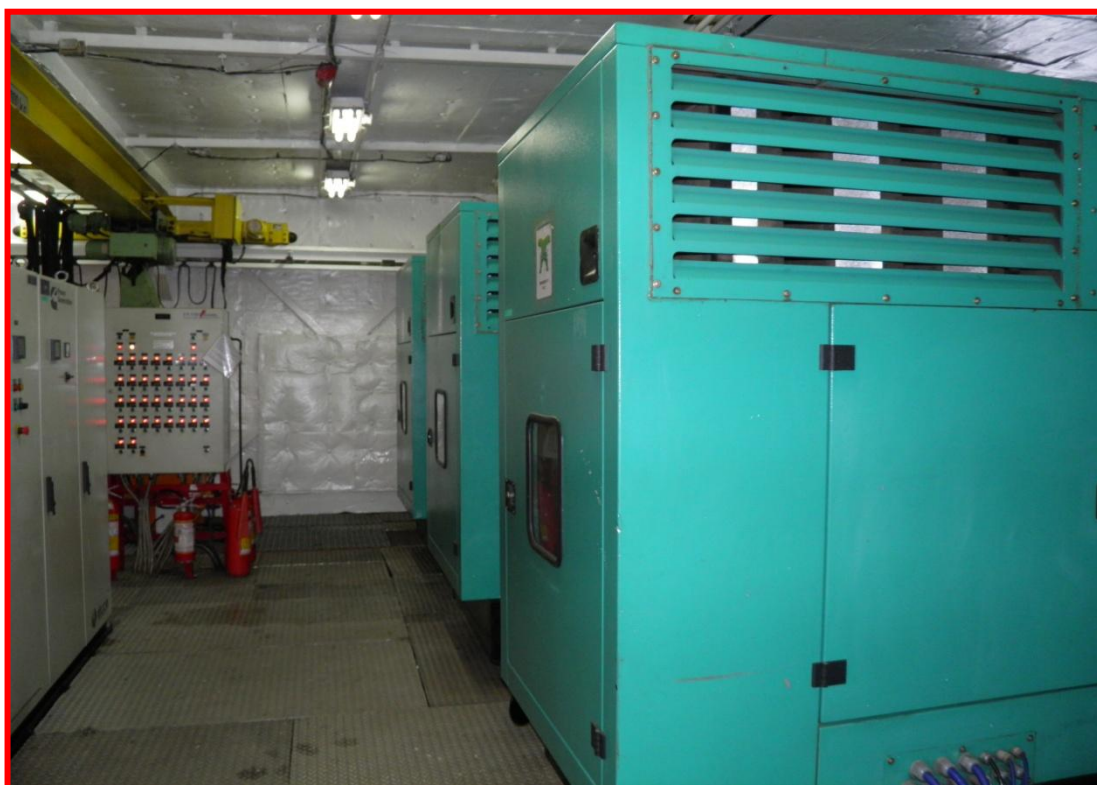
Fotografia 22: Sala de Máquinas, onde se acredita ter iniciado o incêndio de 25/02/ 2012. Fonte: Autor - Operação Antártica XXIX (2010-2011).
