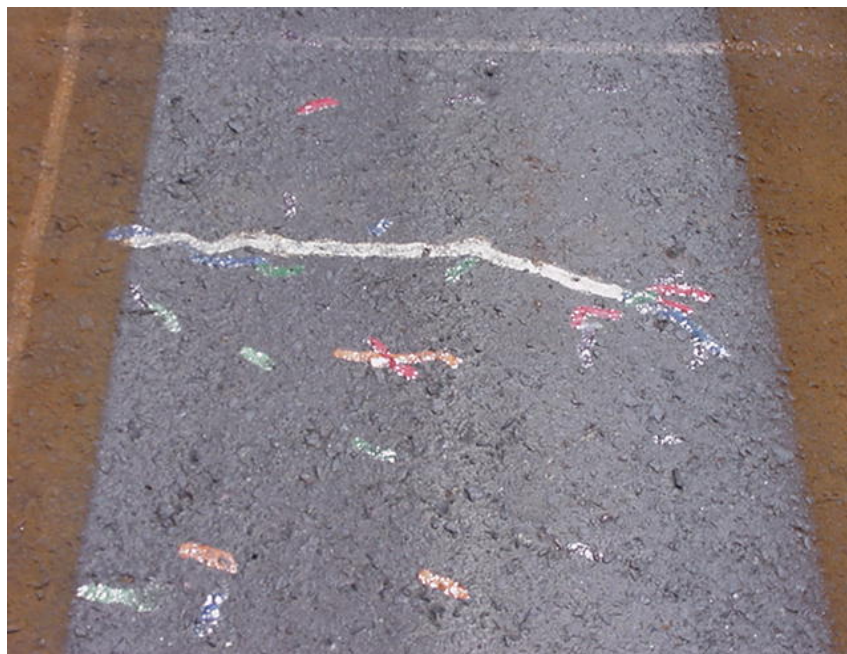
Figura 5.11: Trincas pintadas em cores diferentes indicando a ordem do surgimento
