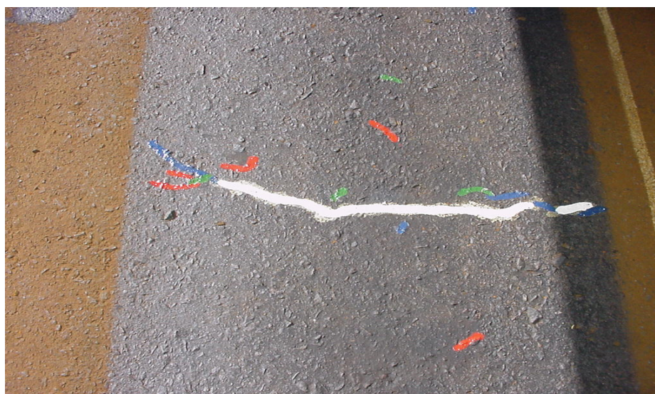
Figura 6.38: Foto do trincamento na seção 3 quando N= 205.000
