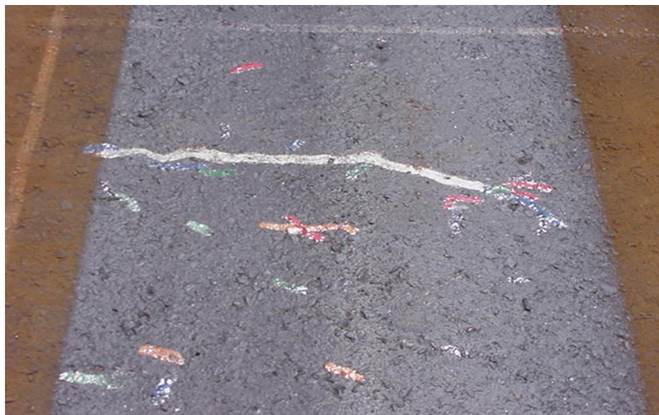
Figura 6.39: Foto do trincamento na seção 3 quando N= 462.000
