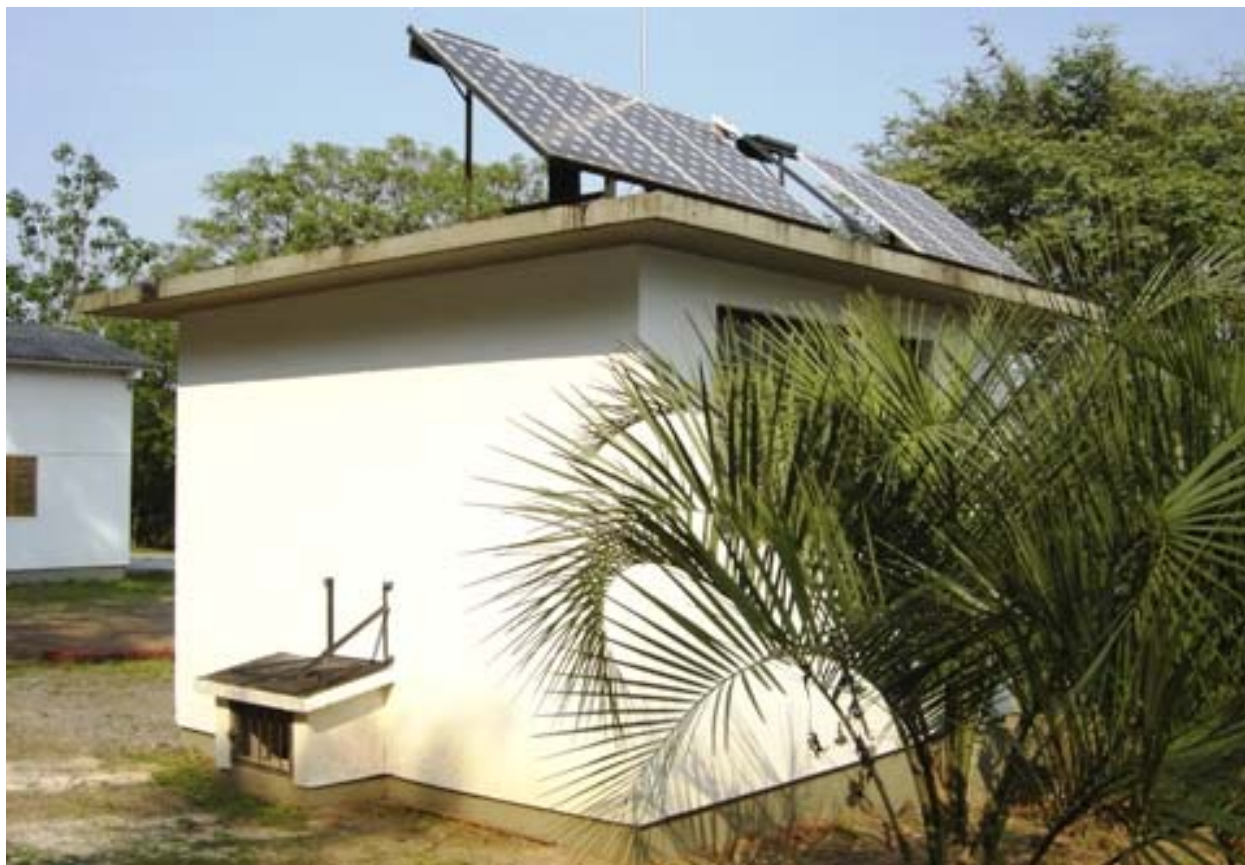
Figura 4.20 Laboratório de Energia Solar da Unisinos. Aparecem em destaque dois arranjos fotovoltaicos montados sobre a cobertura do prédio.
