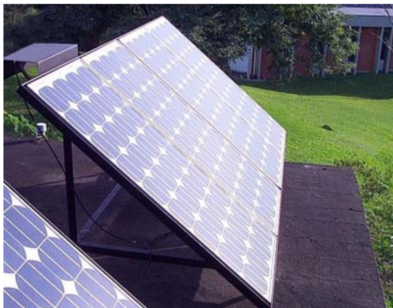
Figura 4.3 Ilustração da montagem do arranjo configurado com quatro módulos. Note-se a inclinação da estrutura em relação ao plano da cobertura do laboratório.
