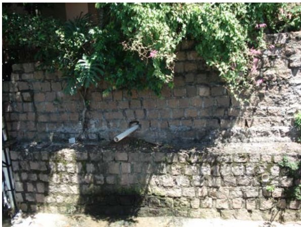
Figura 4.15 - Lançamento de esgoto direto no arroio Capivara Trabalho de Campo: 09-02-2010
