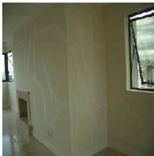
Figura 75 – Fissuras de retração na argamassa
