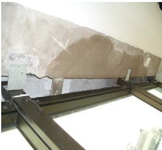
Figura 56 – Infiltração pela interface verga e esquadria
