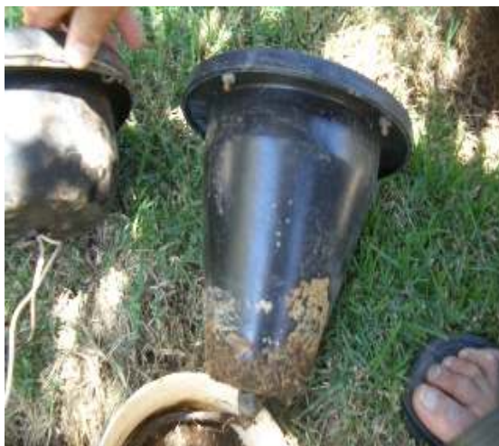
Figura 68 – Má execução de circuito externo
