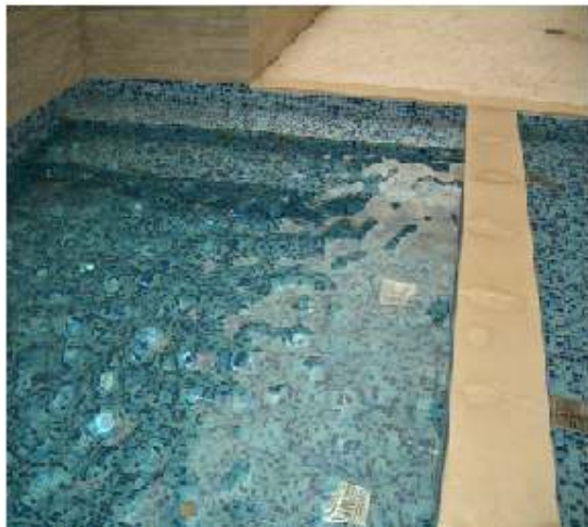
Figura 77 – Área da piscina onde ocorreu falha de impermeabilização
