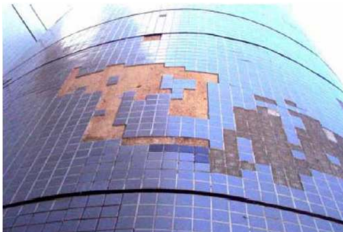
Figura 33 – Destacamento do revestimento cerâmico de fachada
