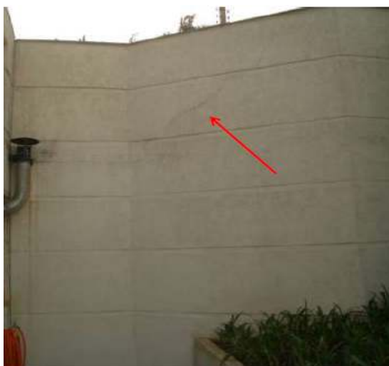
Figura 73 – Fissura devido a recalque de fundação
