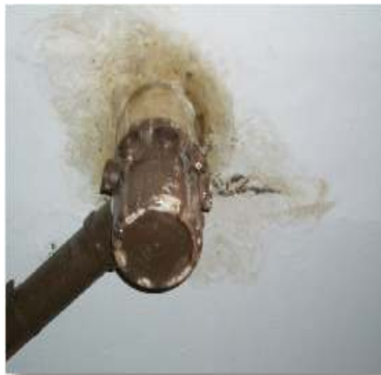
Figura 82 – Infiltração na área do ralo
