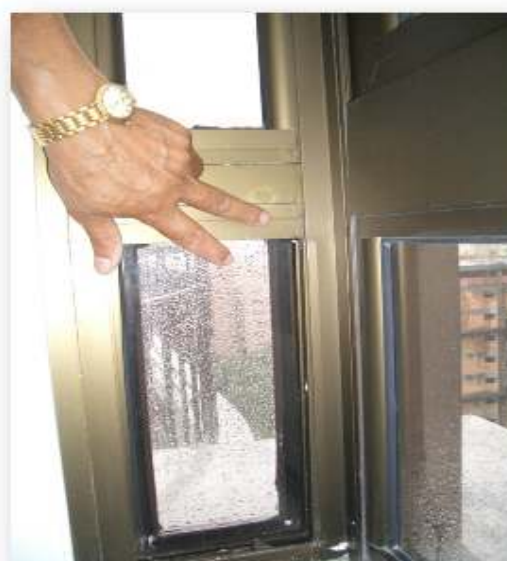
Figura 53 – Má vedação entre vidro e caixilho da esquadria
