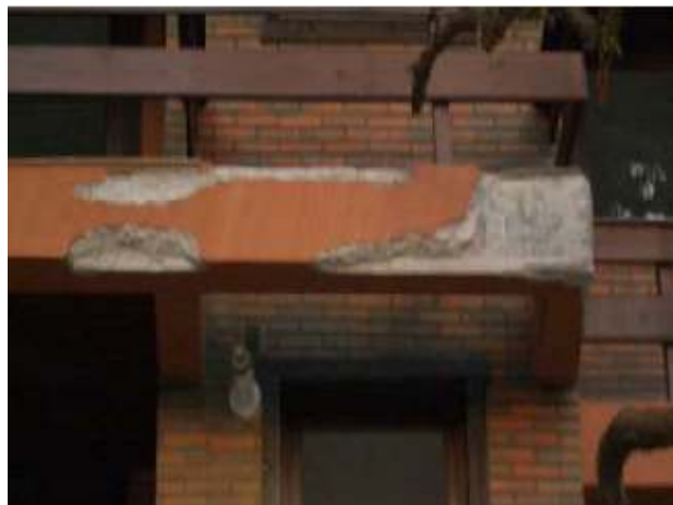
Figura 76 – Descolamento da camada de revestimento sobre superfície de concreto
