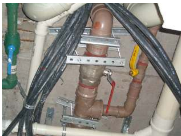
Figura 65 – Interferência entre elétrica e hidráulica
