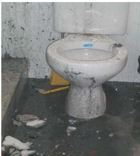
Figura 61 – Entupimento na rede de esgoto
