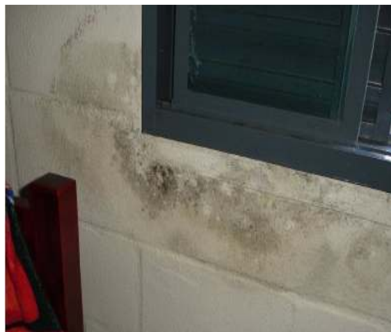
Figura 25 – Caso de umidade devido à infiltração na região próxima ao peitoril
