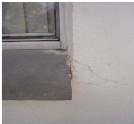
Figura 28 – Falta de prolongamento do peitoril em relação às arestas laterais da janela
