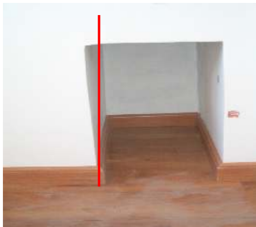
Figura 71 – Problemas de falta de esquadro e de prumo
