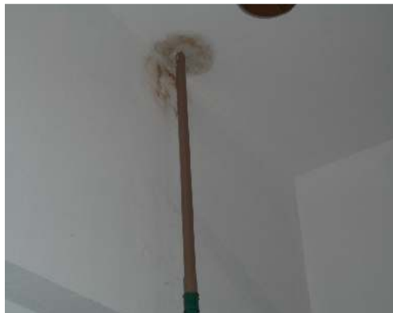
Figura 60 – Vazamento em tubulação de água fria
