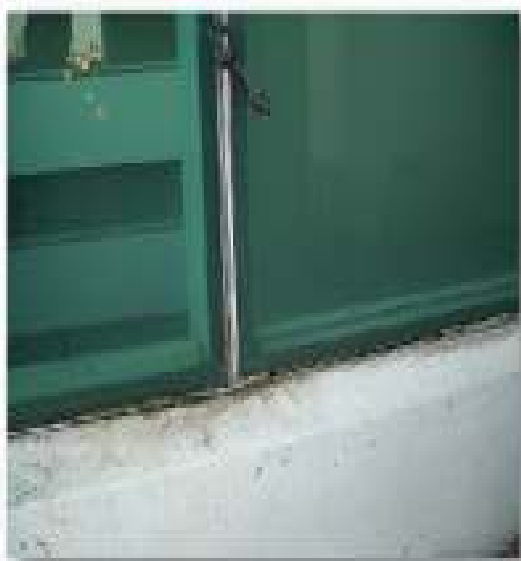
Figura 52 – Manchas de umidade decorrentes de infiltração pela fachada de pele de vidro
