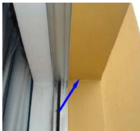
Figura 30 – Caso propício de infiltração pela interface janela/verga
