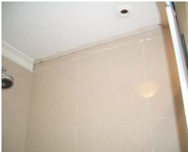
Figura 89 – Descolamento da moldura de gesso
