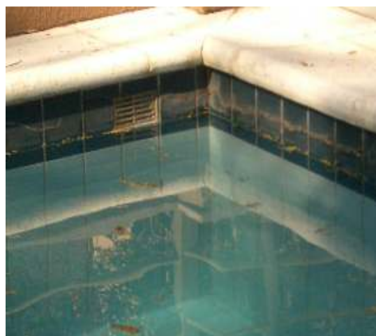
Figura 88 – Peças cerâmicas com eflorescências
