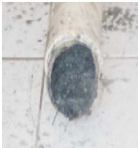
Figura 62 – Entupimento de tubulação de esgoto
