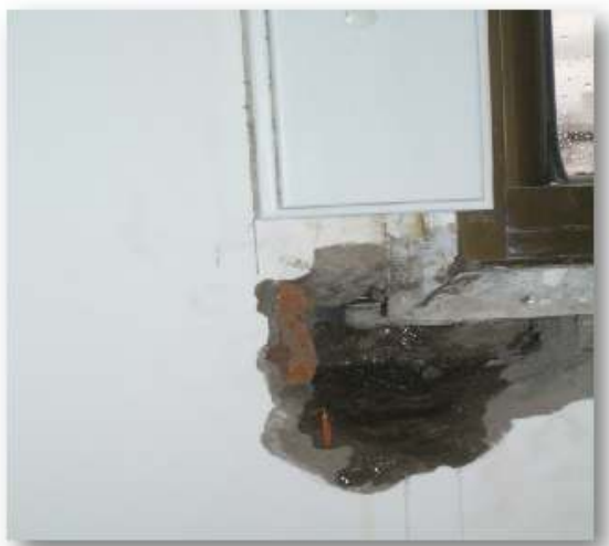
Figura 54 – Infiltração na interface entre peitoril e esquadria
