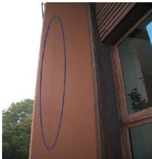
Figura 74 – Fissura na interface entre alvenaria e pilar de concreto
