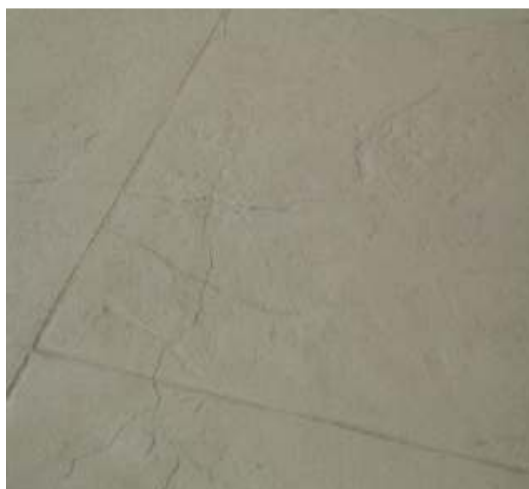
Figura 86 – Peças cerâmicas fissuradas
