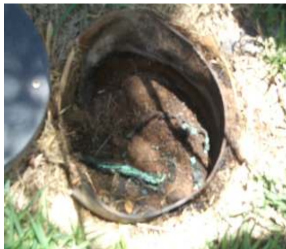
Figura 69 – Isolamento inadequado de circuito externo
