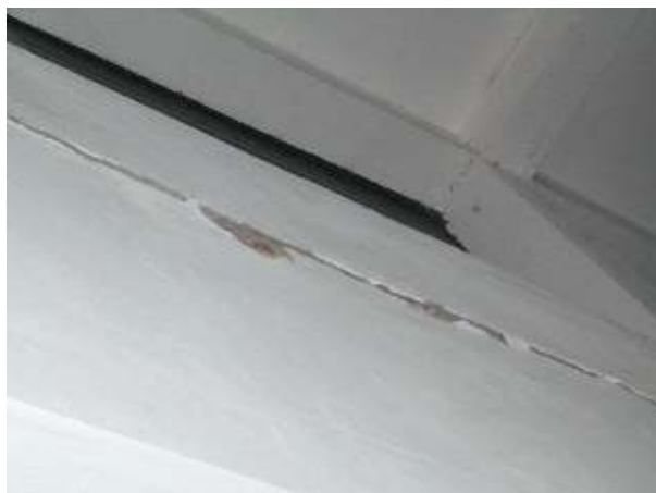
Figura 72 – Fissuração no encontro entre viga e alvenaria
