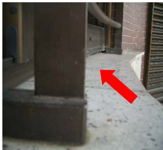
Figura 55 – Má vedação entre peitoril e esquadria
