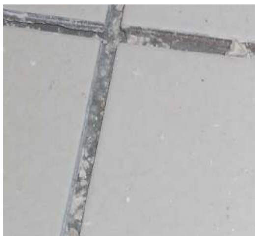
Figura 87 – Deterioração das juntas de assentamento
