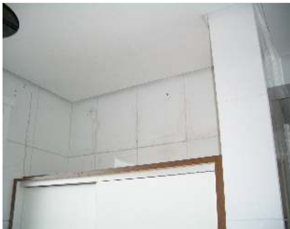
Figura 59 – Vazamento em tubulação de água quente
