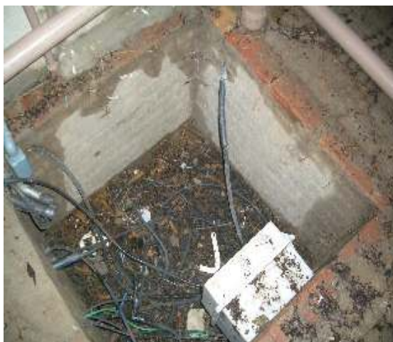
Figura 66 – Infiltração de água na rede elétrica
