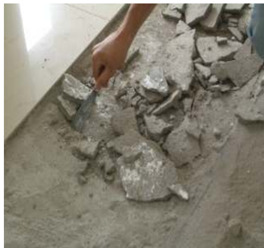
Figura 84 – Descolamento do contrapiso
