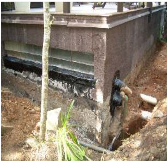
Figura 81 – Interferência de tubulações na execução da impermeabilização
