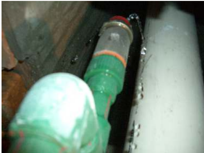
Figura 63 – Vazamento em válvula de coluna de água
