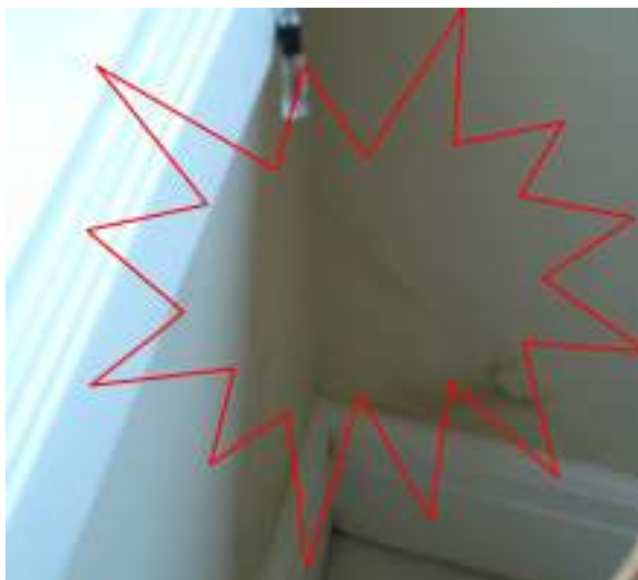
Figura 79 – Mancha de umidade devido à infiltração em área externa
