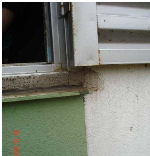
Figura 27 – Infiltração pela interface janela/peitoril
