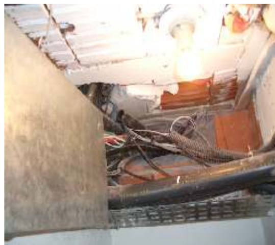
Figura 67 – Rede elétrica sem proteção e suscetível à entrada de água
