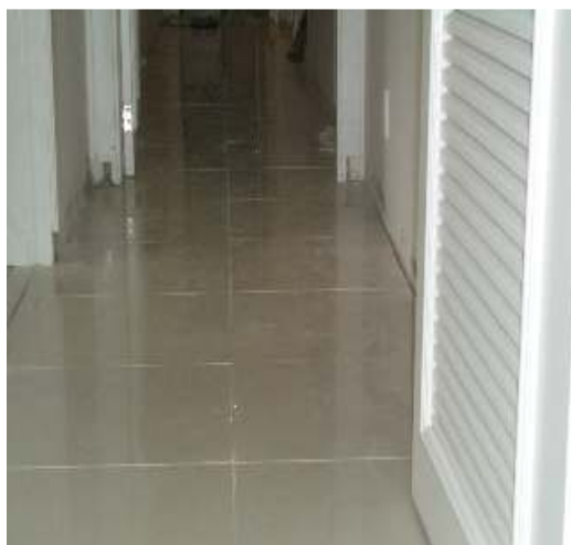
Figura 85 – Desnível entre peças cerâmicas
