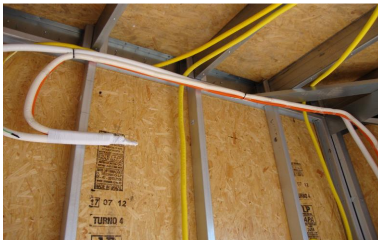
Figura 28 – Passagem de tubulação
