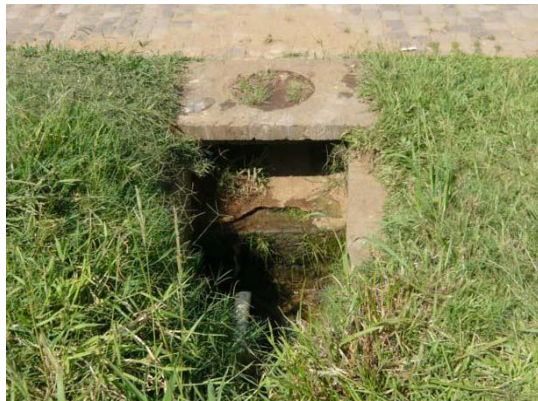
Bueiro aberto (Rua Irmã Teresilda Steffen)
