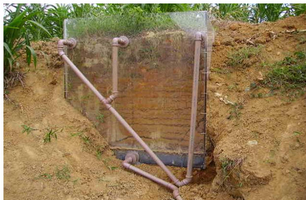
Figura 3-8 - Instalação dos equipamentos de coleta de escoamento no lisímetro LCM Lontras - SC.
