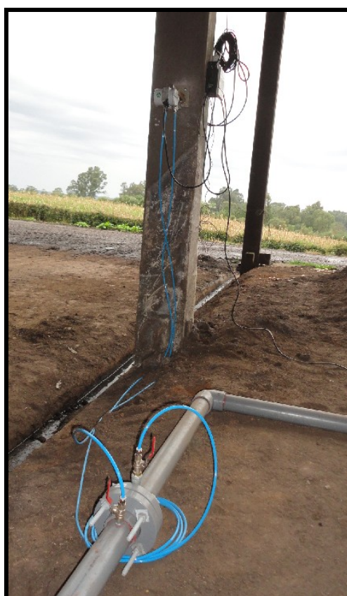
FIGURA 58 – Placa de Orifício ente flanges na parte inferior da foto e o transmissor de pressão diferencial preso ao pilar.
