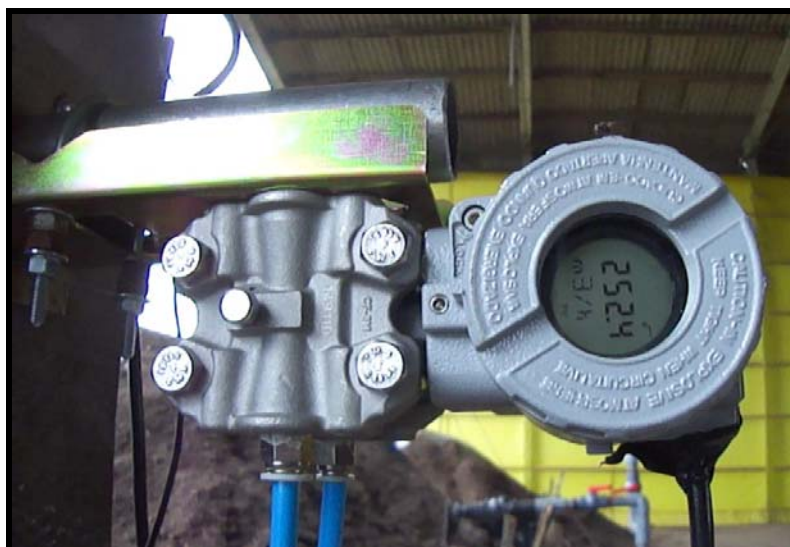
FIGURA 57 – Transmissor de Pressão Diferencial para medição do fluxo de ar.
