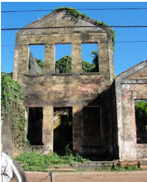
Figura 25: Ruínas da fachada do antigo Educandário Nogueira de Faria. Fonte: Foto: ZATREPALEK, P., junho 2011.
