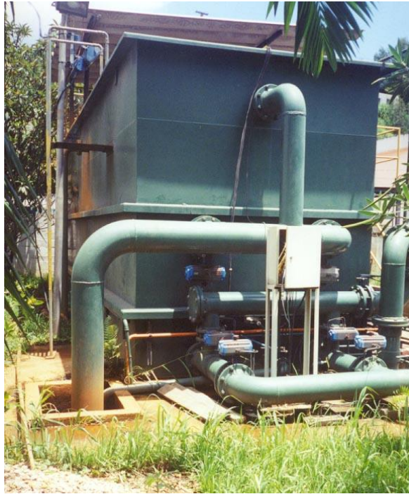
Figura 13. Unidade de flotação da ETA Mairiporã da Sabesp (Fonte: Centroprojekt do Brasil).
