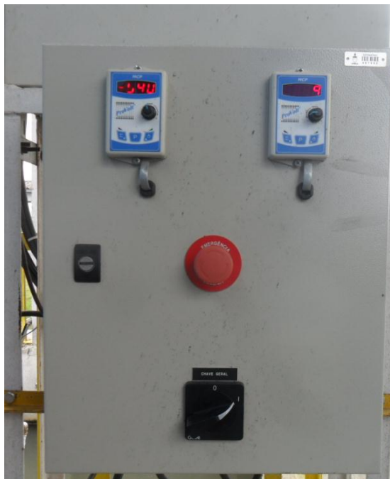
Figura 38. Painel elétrico com inversores de frequência para ajuste da rotação dos motores de agitação nos tanques de coagulação/floculação. Outras especificações são detalhadas na Tabela 9.
