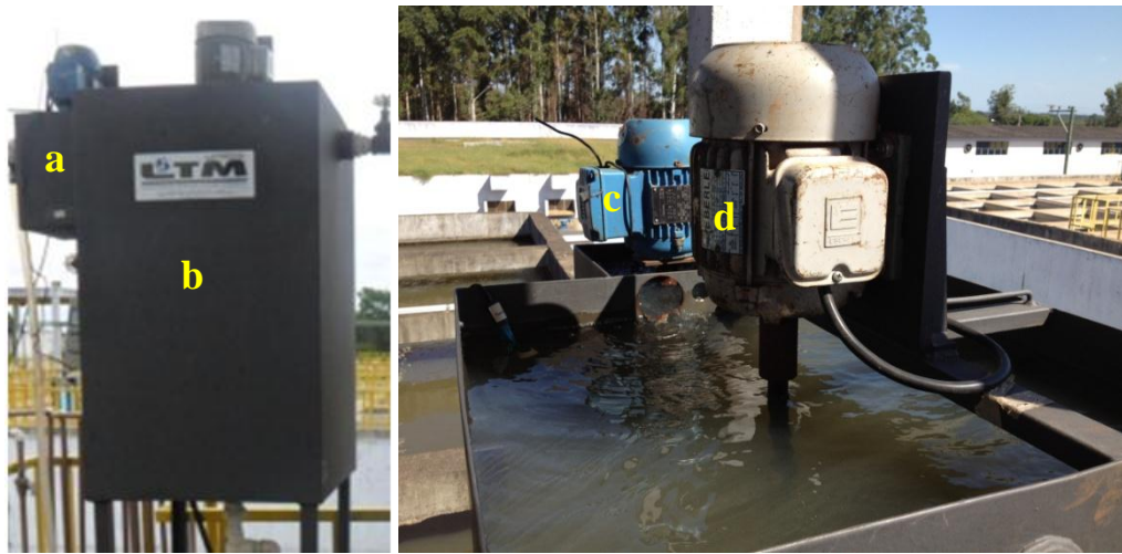
Figura 36. Sistema de tanques de mistura mecanizada usado nas etapas de coagulação/floculação em nível piloto. a) Tanque de mistura rápida; b) Tanque de mistura lenta; c) Motor elétrico para mistura rápida; d) Motor elétrico para mistura lenta. Outros detalhes construtivos são descritos na Tabela 9.
