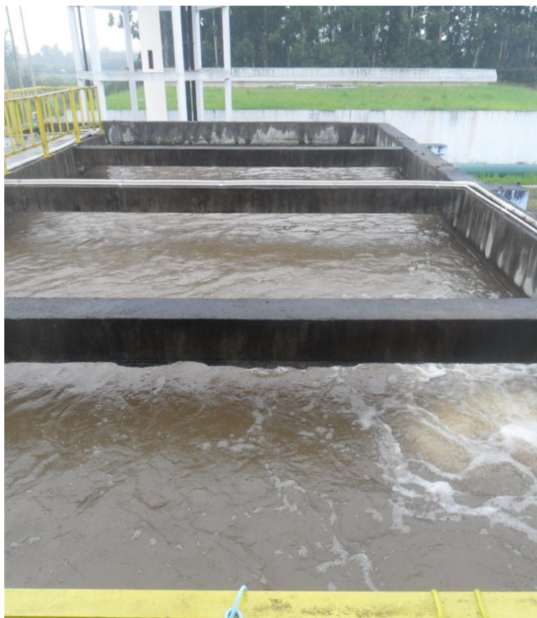
Figura 43. Tanque de recepção (equalização) de água bruta da ETA Rio Branco da Corsan (Canoas-RS).
