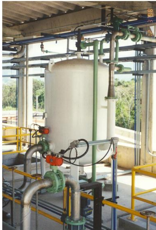
Figura 15. Vaso saturador utilizado na ETA Porto Novo da Sabesp, que abastece os municípios de Caraguatatuba e São Sebastião, no Estado de São Paulo (Fonte: Centroprojekt do Brasil).
