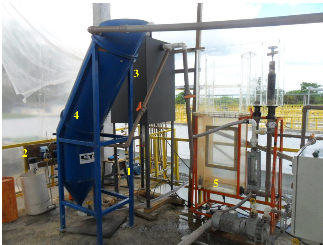
Figura 33. Sistemas de tratamento de água em nível piloto e descrição de suas unidades básicas. 1) Bombeamento (alimentação); 2) Dosagem de reagentes; 3) Coagulação/floculação; 4) Sedimentação Lamelar - SL; 5) Flotação de ar dissolvido com bomba multifásica – FAD-B.
