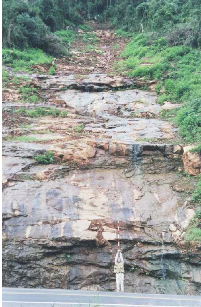
Figura 9 - Talude em rocha com as discontinuidades favorecendo as instabilizações de blocos e solo na parte superior do talude, km 42+930 a 42+970 da RS 122 (Azambuja et al. , 2001).
