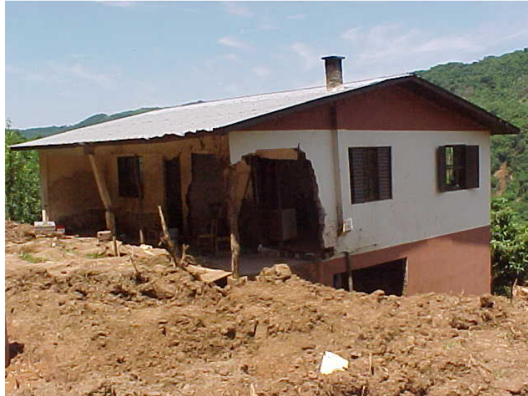
Figura 3 – Deslizamento de encosta em Alto Feliz, com quatro vítimas fatais.
