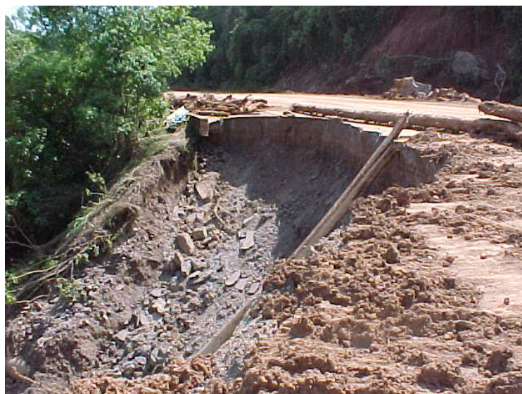
Figura 4 – Trecho da rodovia RS 122 interrompido, com destruição parcial da pista.
