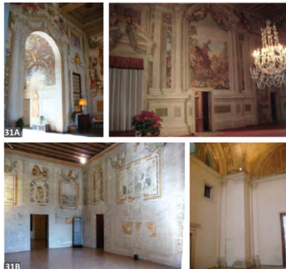
Fig. 31: salas das villas: (A) Emo, (B) Godi , (C)Badoer e (D) Pisani Bagnolo. Fonte: Autora, 2010
